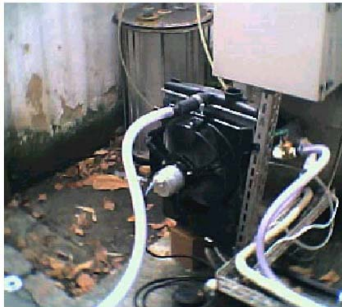
Figura 17: O radiador como carga térmica.
