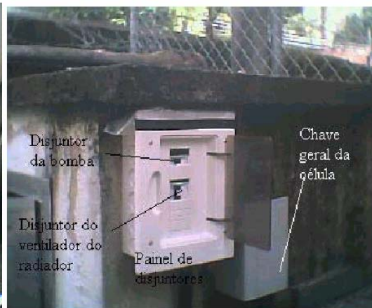
Figura 18: O painel de disjuntores para a bomba d'água e para o ventilador do radiador.
