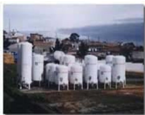
Figura 6A - Tanque estacionário
