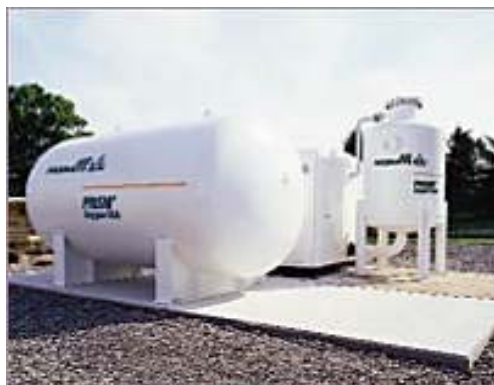
Figura 6B - Tanque estacionário
