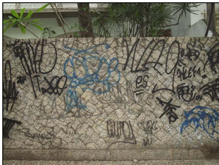
(Fig. 2) Piche em muro da Rua Fonte da Saudade – Lagoa-RJ (Brasil) Foto de Anderson Tibau – 2005 (Acervo pessoal) “Pichação”
