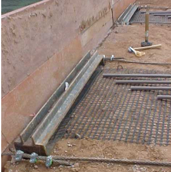
Figura 104 - Detalhe da manga metálica, dos tubos dos tell-tales e dos cabos de aço de amarração dos trilhos.
