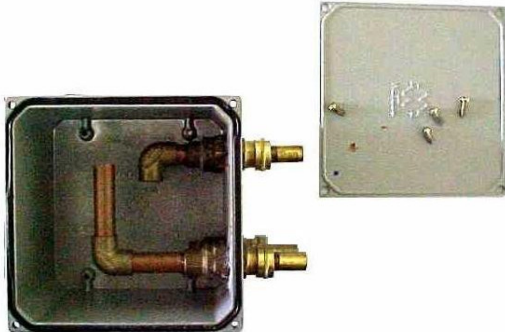
Figura 99 – Detalhes da caixa sueca: a) vista dos três tubos no interior da caixa e b) vista da tampa metálica e parafusos.
