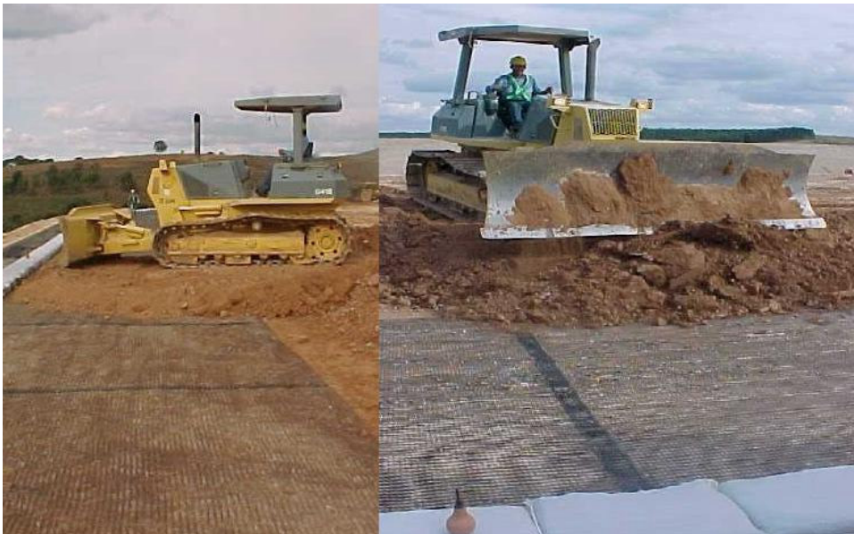
Figura 86 - Lançamento da camada de solo sobre a geogrelha por trator de esteiras D4.
