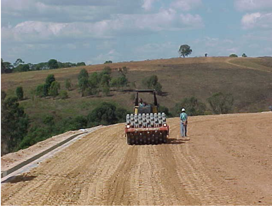
Figura 89 - Compactação da camada por meio de rolo compressor vibratório pata curta CA-25
