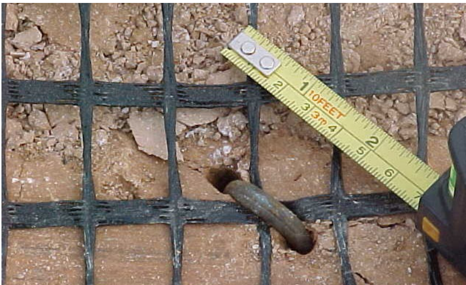
Figura 84 - Detalhe da fixação da geogrelha por grampo de metal em forma de U invertido cravado no solo.
