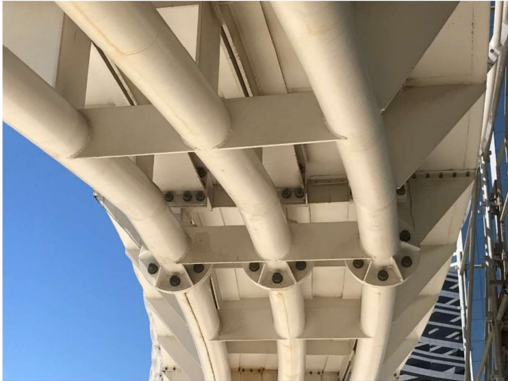
Figura 20 – Passarela Terminal Centro Olímpico: Vista dos elementos componentes da superestrutura (Dias e Souza, 2017)
