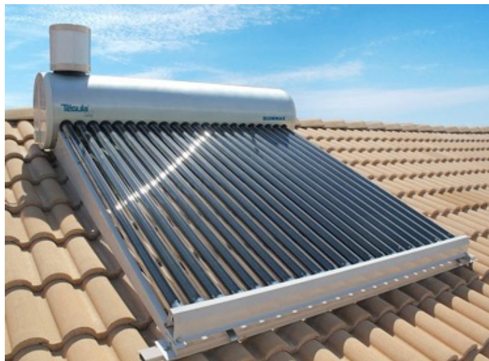
Figura 6.19: Coletor solar a vácuo. Fonte: Esfera Energia Solar (2018).
