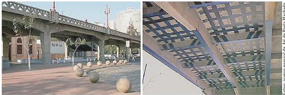
Figura 2.1 - Reforço com compósito de fibras de carbono no Viaduto Santa Tereza, Belo Horizonte. Fonte: Techne. Disponível em: < http://techne17.pini.com.br/engenharia-civil/125/imagens/125construir1.jpg > Consulta em 01/10/2018.
