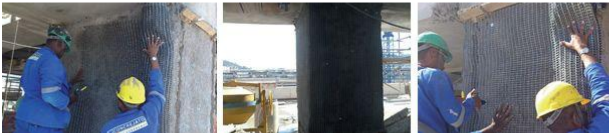
Figura 2.4 – Reforço de pilares de concreto armado no estádio Maracanã. Fonte: Techne. Disponível em: < http://techne17.pini.com.br/engenharia-civil/194/imagens/i381178.jpg > Acessado em 18/10/2018.
