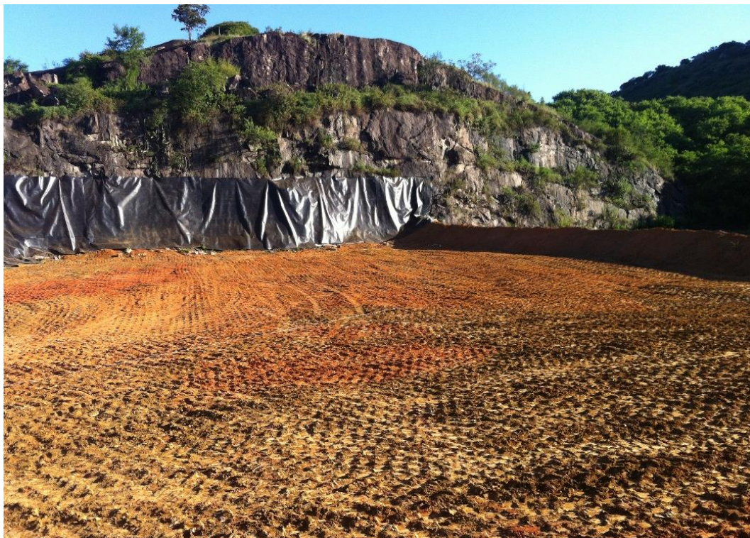
Figura 62 – Jazida Barreira mineral de fundo de parte da célula de disposição final do aterro de rejeitos de rochas ornamentais.
