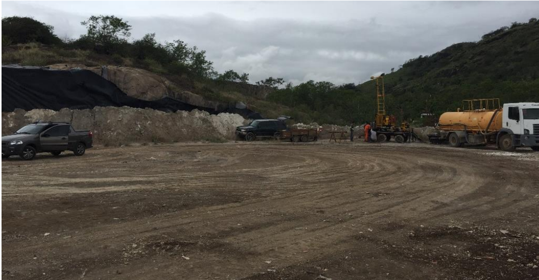
Figura 74 – Vista do local de instalação do piezômetro PM 1 instalado na área monitorada.
