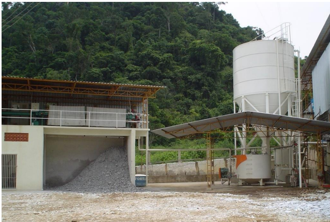
Figura 57 – Sistema de tratamento de efluentes industriais em indústria de beneficiamento de rochas ornamentais, com detalhe para a lama desaguada gerada pelo filtro prensa.
