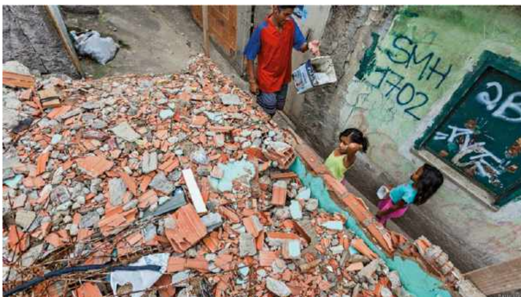
Figura 06 - Casa demolida pela Secretaria Municipal de Habitação do Rio (Diniz, 2015)
