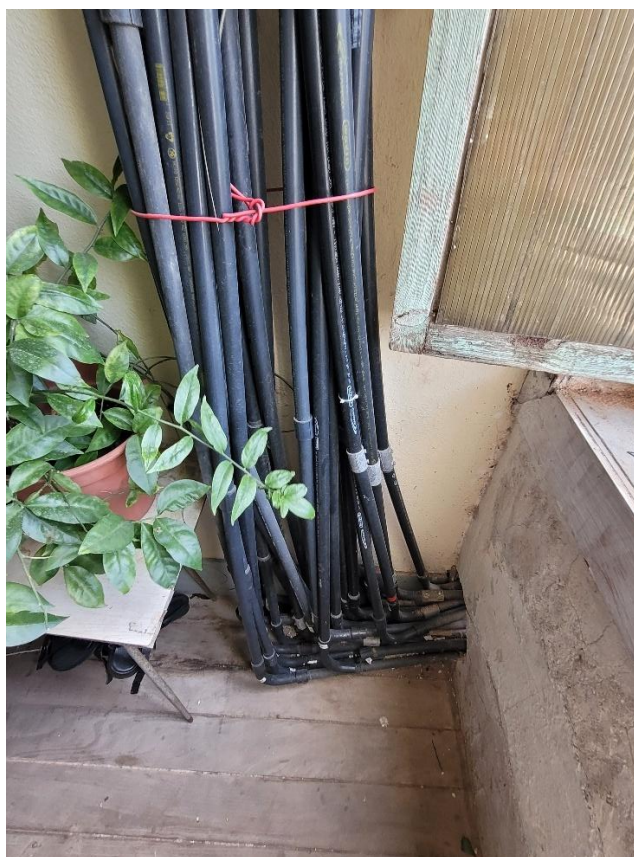
Figura 26: Fiação chegando na circulação dos pavimentos. Fonte: Disciplina ARQ1325 e ARQ2019. 2024.
