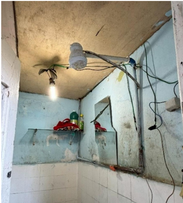
Figura 24: Banheiro com fiação exposta. Fonte: Disciplina ARQ1325 e ARQ2019 (2024).
