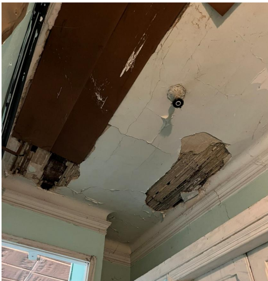
Figura 27: Presença de infiltração na circulação. Fonte: Disciplina ARQ1325 e ARQ2019 (2024).
