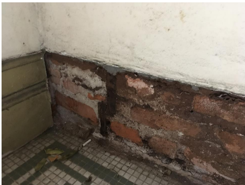
Figura 5.7 – Trecho de parede sem reboco.
