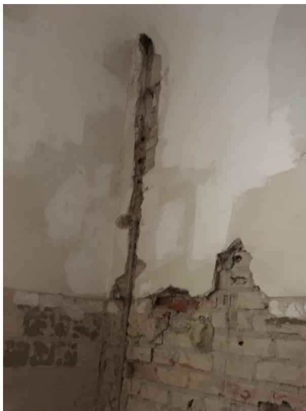
Figura 5.6 – Trecho de parede sem reboco.
