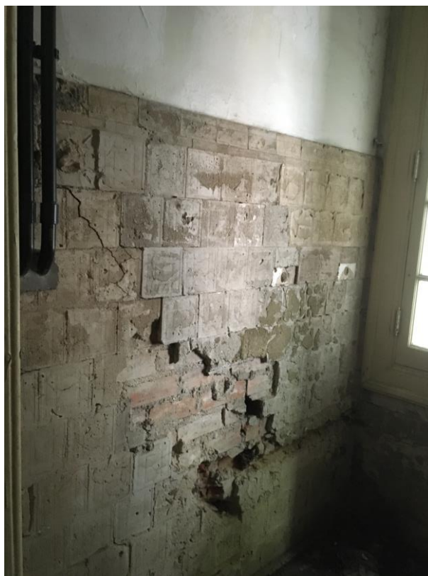
Figura 5.4 – Trecho de parede sem reboco.
