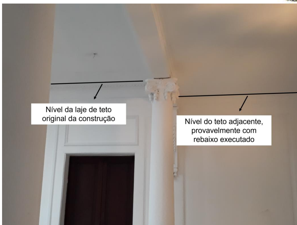
Figura 6.7 – Desnível identificado no segundo pavimento, em cima do vão da escada quando da visita técnica.
