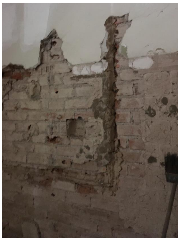
Figura 5.5 – Trecho de parede sem reboco.
