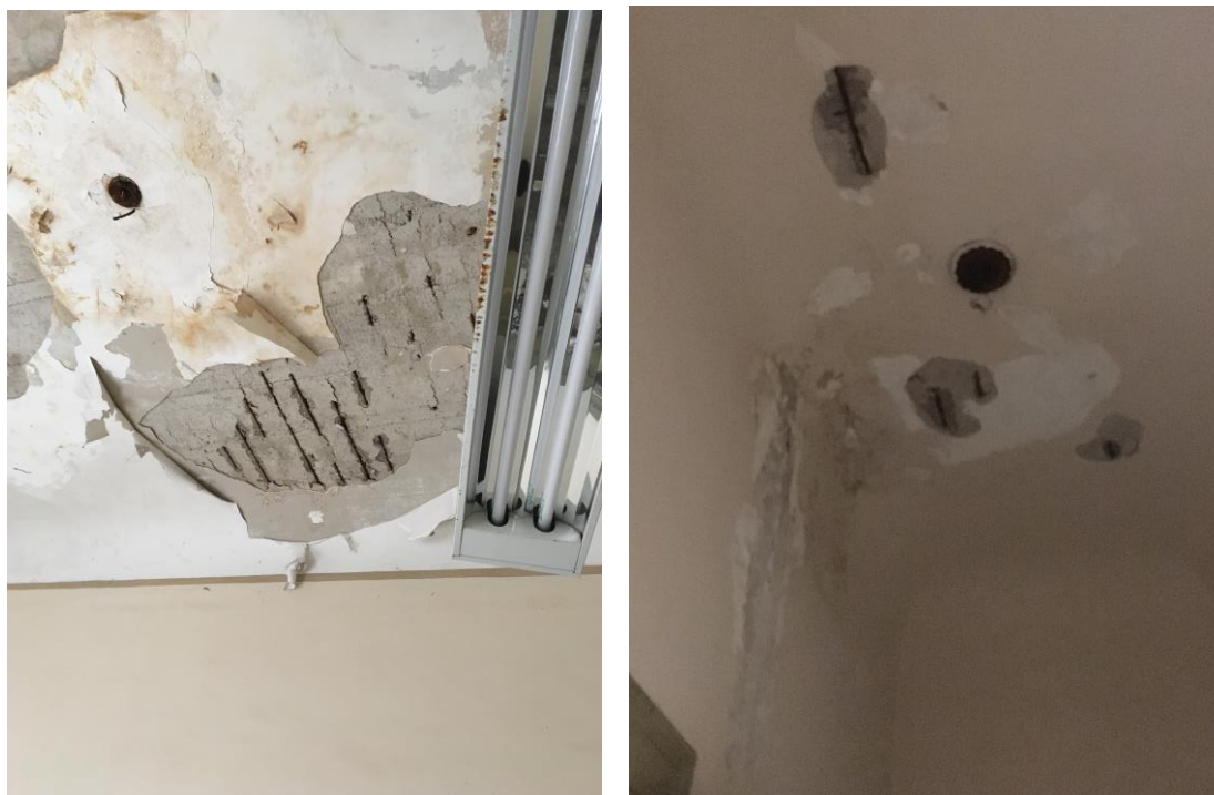
Figura 5.10 – Lajes danificadas, com pontos de exposição de armadura de aço.
