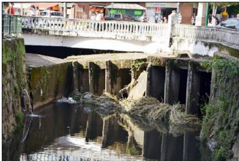
Figura 22 - Tomada do Túnel Extravasor do rio Palatino Obstruída. Fonte: INEA (2022)
