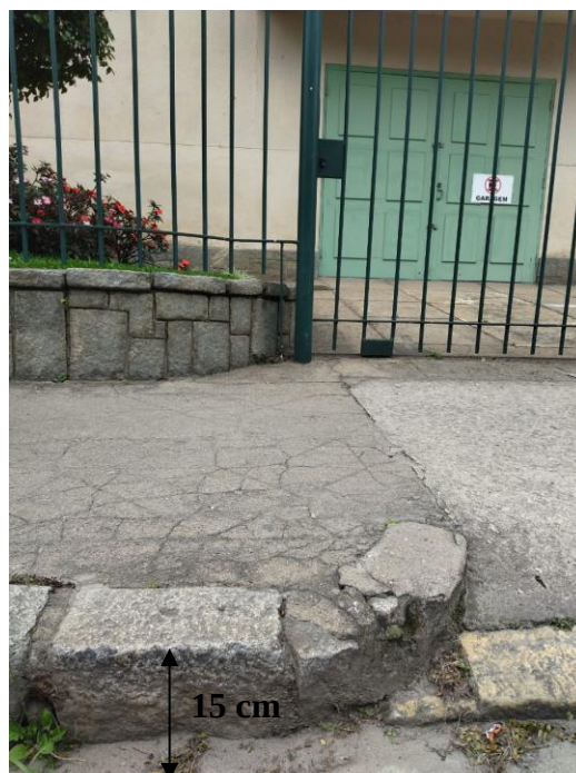
Figura 45 - Medição do desnível entre a rua e a calçada. Fonte: Autora
