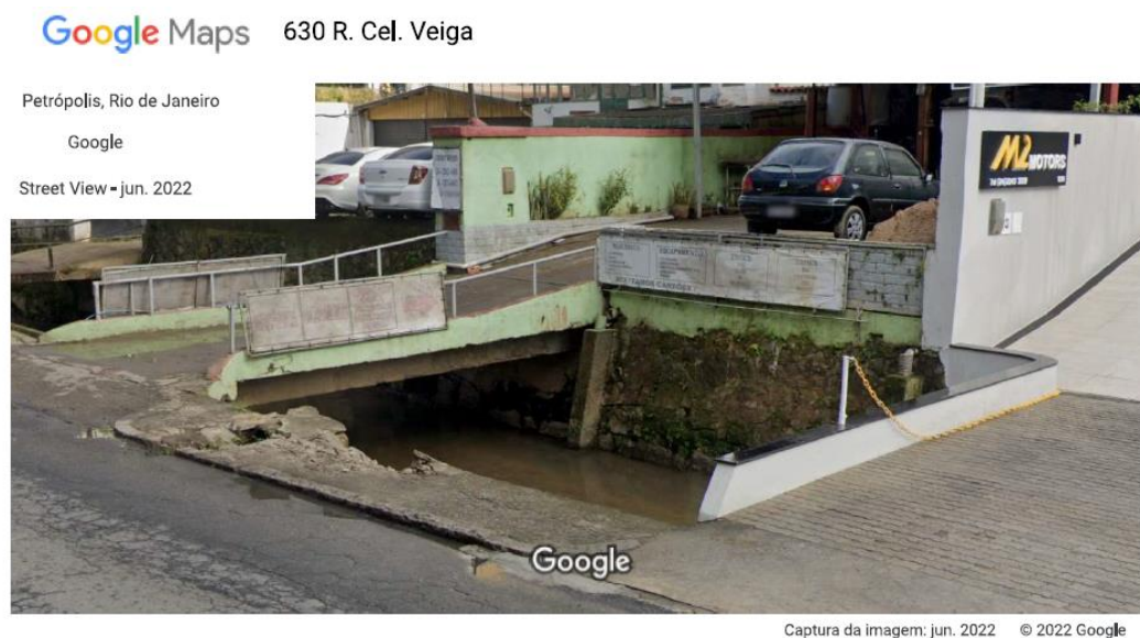
Figura 27 - Pontes na margem direita do rio Quitandinha, no nº 630 da rua Coronel Veiga, bairro de Valparaíso, Petrópolis, RJ. Fonte: Google Maps
