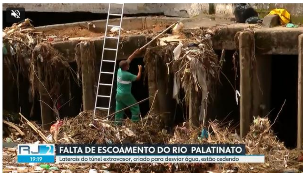
Figura 23 - Condições do túnel extravasor do Palatino após desastre de fevereiro de 2022. Adaptado de OSÓRIO, G1 Rio (2022)
