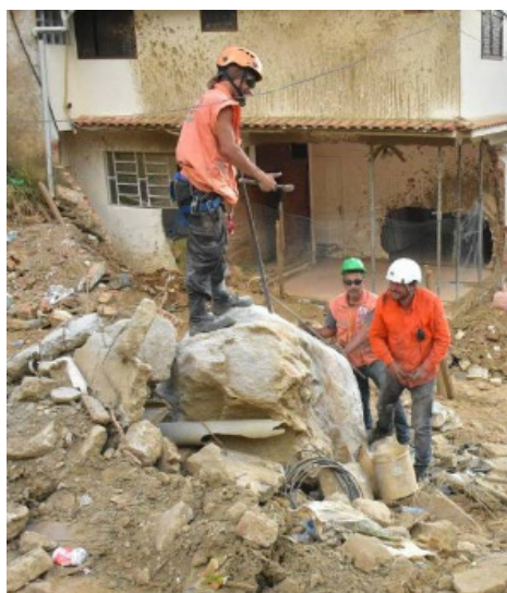
Figura 1.1 – Desmonte de um bloco que atingiu área residencial em Petrópolis, 2022 [14]
