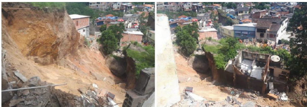
Figura 1.3 – Vista superior do deslizamento de rocha no Morro Boa Esperança. Niterói, 2018 [15]
