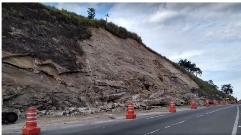
Figura 1.5 – Trecho da BR-393 parcialmente interditado após deslocamentos em talude. Vassouras, 2019 [17]
