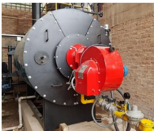
Figura 7: Vista frontal da caldeira flamotubular estudada
