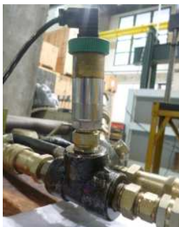
Figura 3.18 – Instrumentação para a medição da carga -Transdutor de pressão
