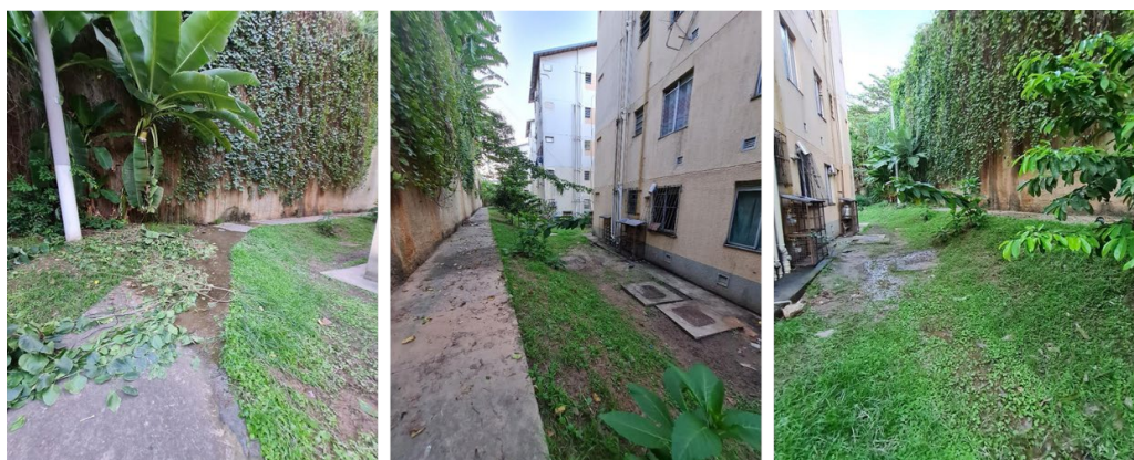
Figura 29 – Imagens do Condomínio Ismael Silva – muro de arrimo parte posterior Fonte: Acervo de imagens da autora
