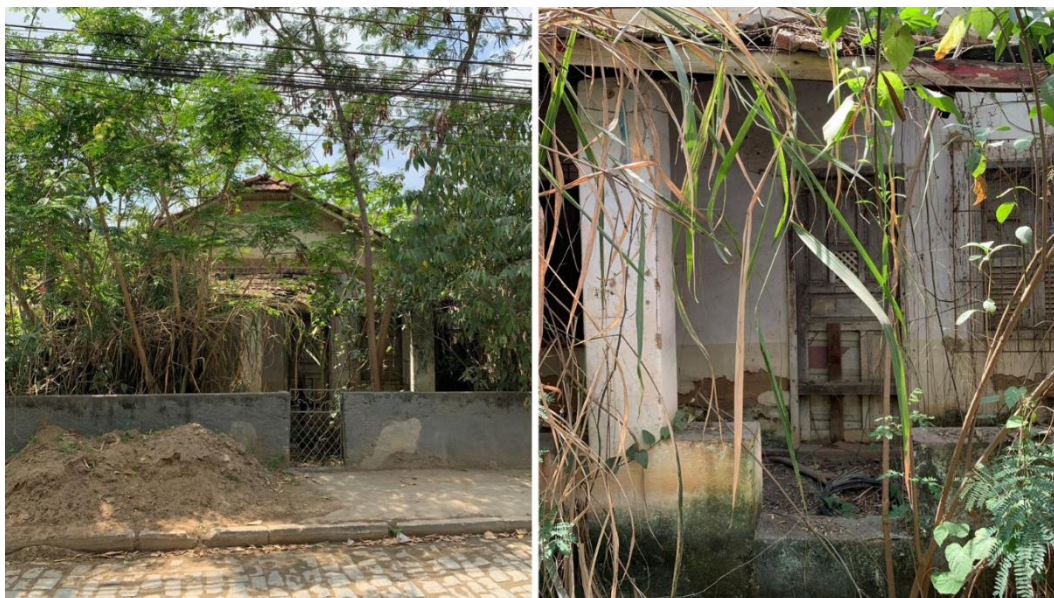
Figura 42 - Residência abandonada no bairro Triângulo, Três Rios, RJ. Fonte: Arquivo pessoal do autor.
