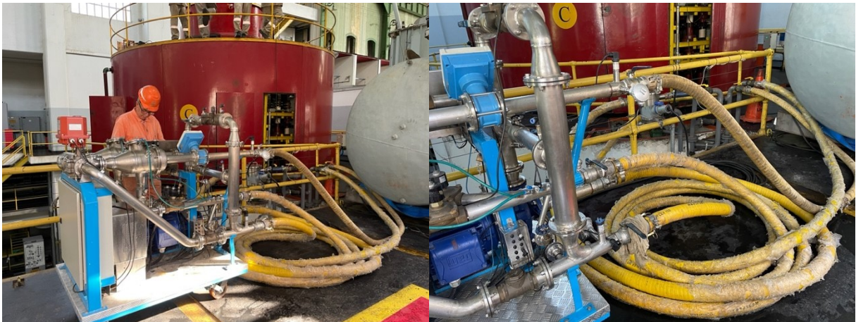
Figura 1.1 Acoplamento do equipamento de limpeza online desenvolvido por pesquisadores da PUC-Rio aos tramos de entrada e de saída da água de resfriamento do trocador de calor (acoplamento realizado por meio de mangueiras flexíveis e engates rápidos).
