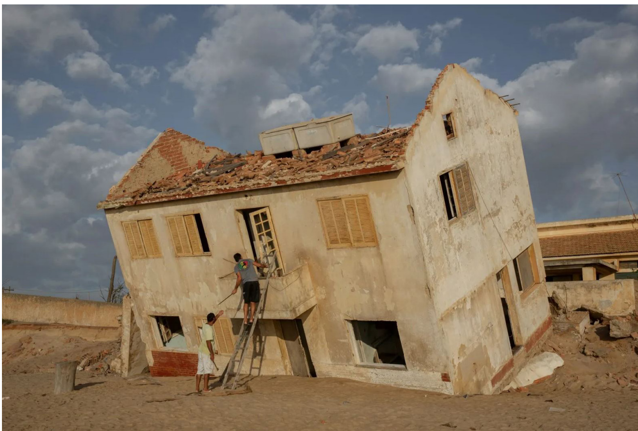
04. Foto de uma construção ruindo no distrito de Atafona, São João da Barra, Rio de Janeiro, em decorrência da erosão costeira.
