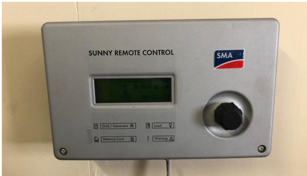
Figura 18 - Medição indireta do estado de carga das baterias por meio do dispositivo Sunny Remote Control do inversor SMA (Elaboração própria, 2021)
