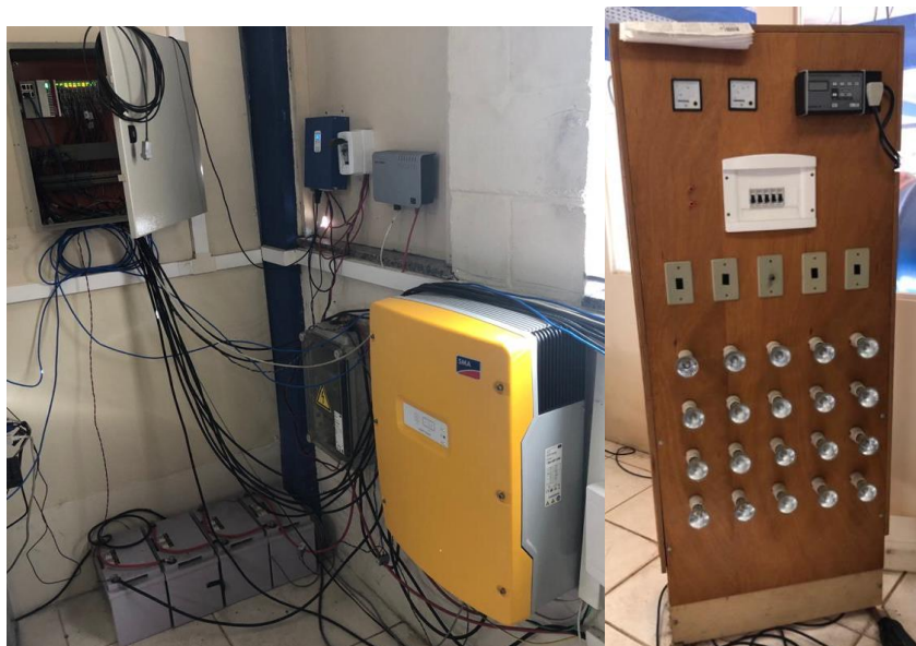
Figura 17 - Vista do inversor e ao lado o BatFuse ; sistema com lâmpadas (Elaboração própria, 2021)
