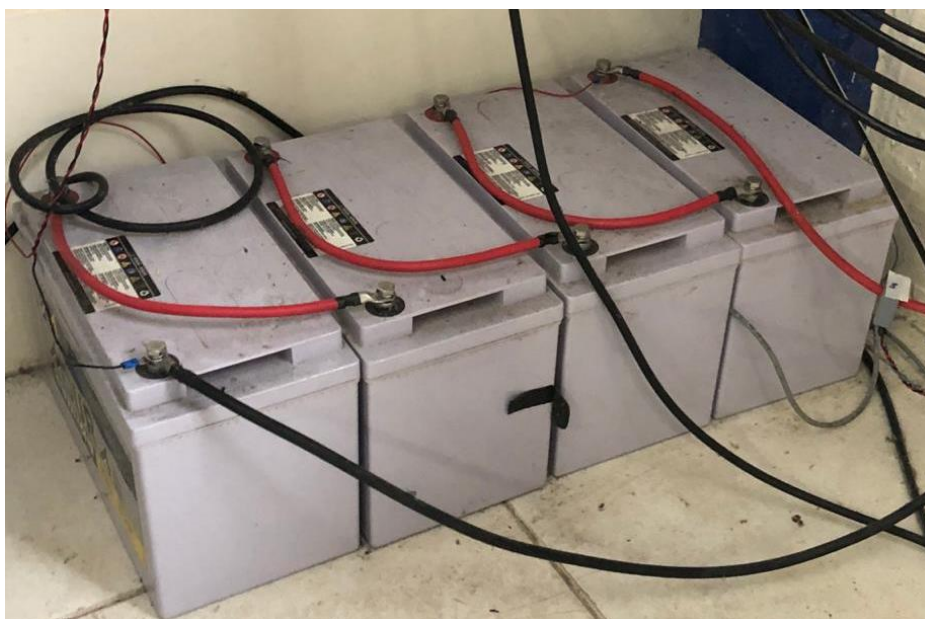
Figura 19 - Vista do banco de baterias empregado no sistema de geração (Elaboração própria, 2021)
