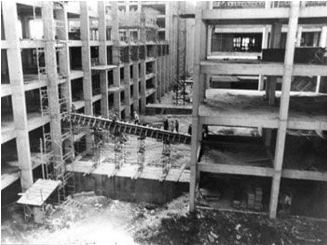
Figura 90: UERJ. Fotografia da construção - Sistema estrutural em concreto armado - Reticulado modular espacial de referência.
