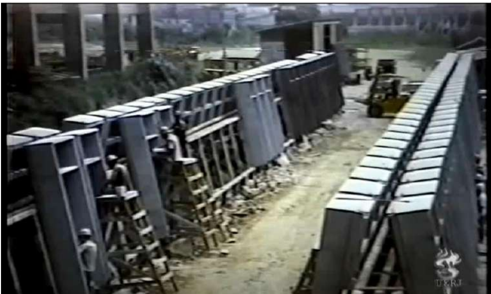
Figura 110: UERJ. Conjunto Escolar. Estocagem de elemento pré-moldado no canteiro de obras. Fonte: Youtube. Disponível em: < https://www.youtube.com/watch?v=4czvMkrkWrU >.
