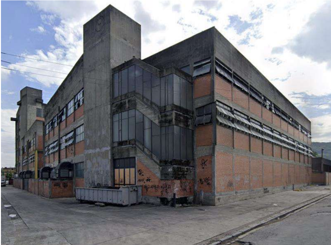
Figura 142: Indústria de Produtos Alimentícios Piraquê. Bloco Conselheiro Galvão-Tapirapuã. Encontro das fachadas na esquina.
