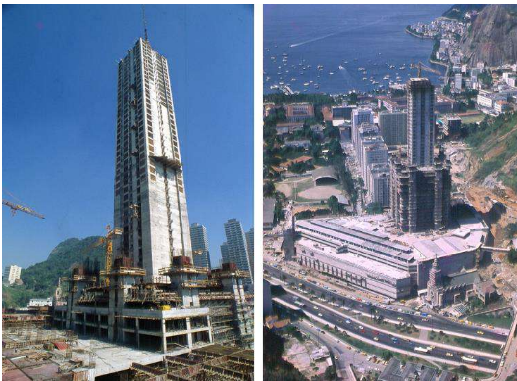
Figura 209: Torre Rio Sul. Fases da construção indicando, a execução do núcleo contraventante em fase anterior à execução das lajes a ele periféricas. Fonte: Acervo Rio Sul Shopping Center.
