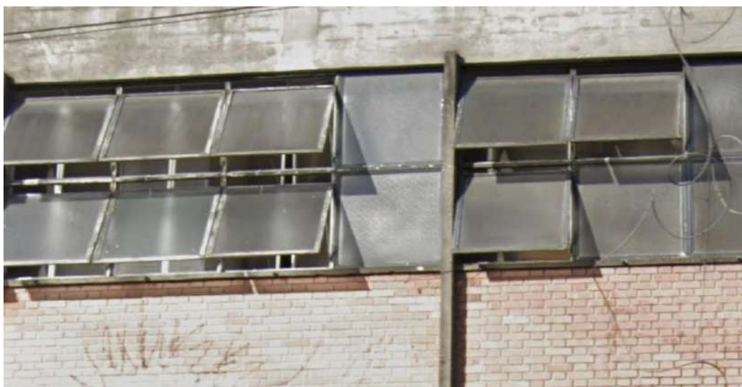
Figura 133: Indústria de Produtos Alimentícios Piraquê. Bloco Conselheiro Galvão. Ampliação de detalhe da fachada.
