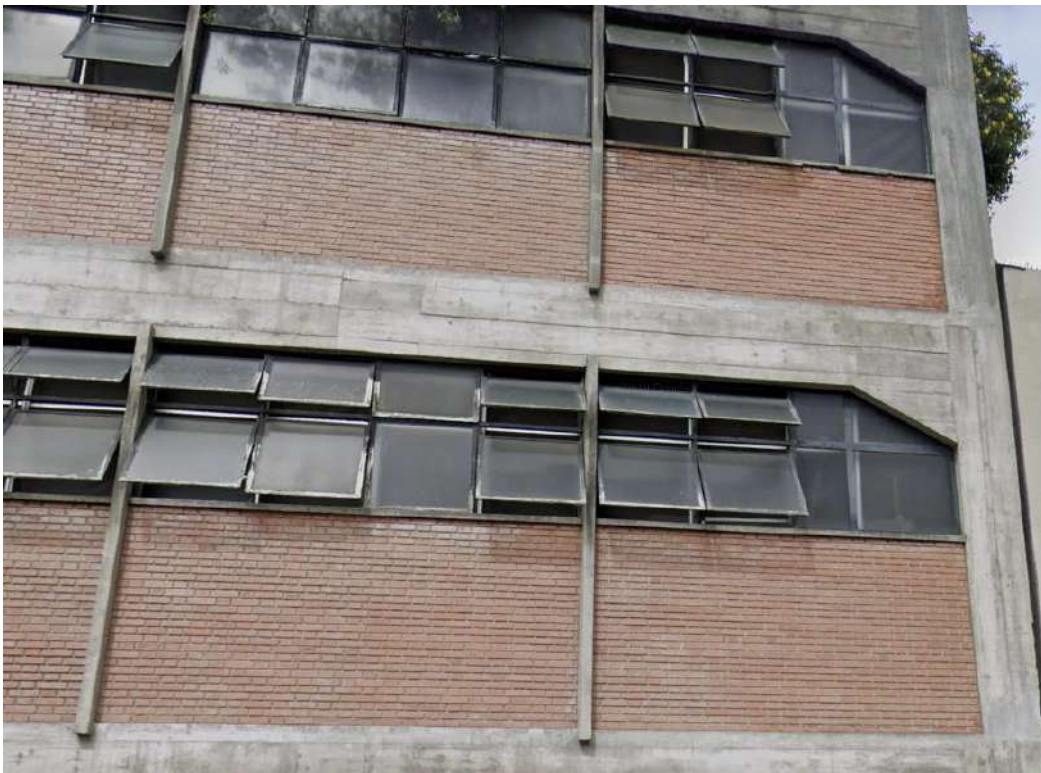
Figura 153: Indústria de Produtos Alimentícios Piraquê. Bloco Leopoldino-Tapirapuã. Fachada. Detalhe de coordenação sistêmica: estrutura x vedações.
