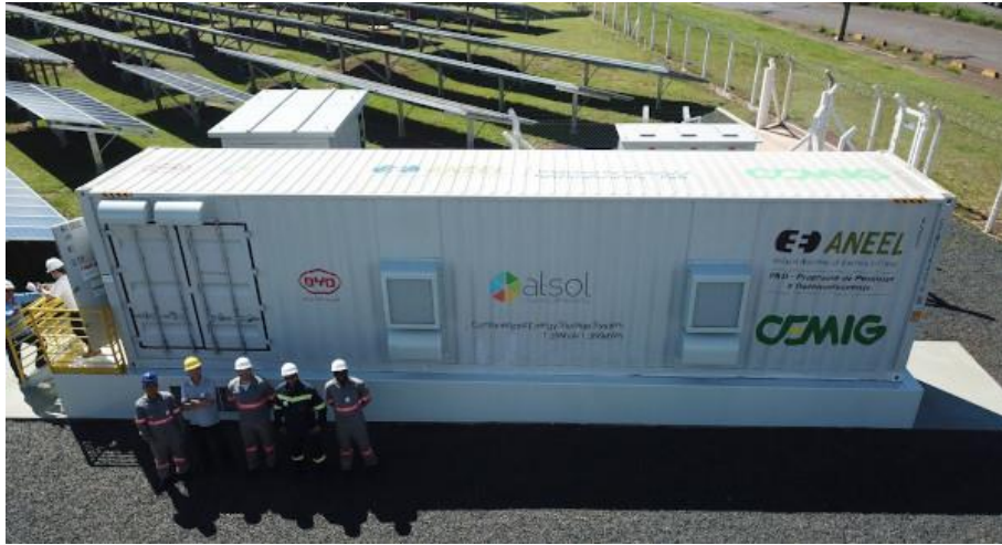
Figura 18: BESS CEMIG instalado em Uberlândia (CEMIG, BYD)
