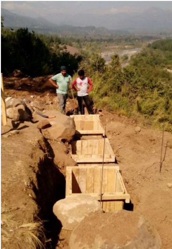
Figura 54: Formas de madeira para as sapatas da fundação estrutural do mirante Fonte: Caderno de memórias de título da Mesona del Rio
