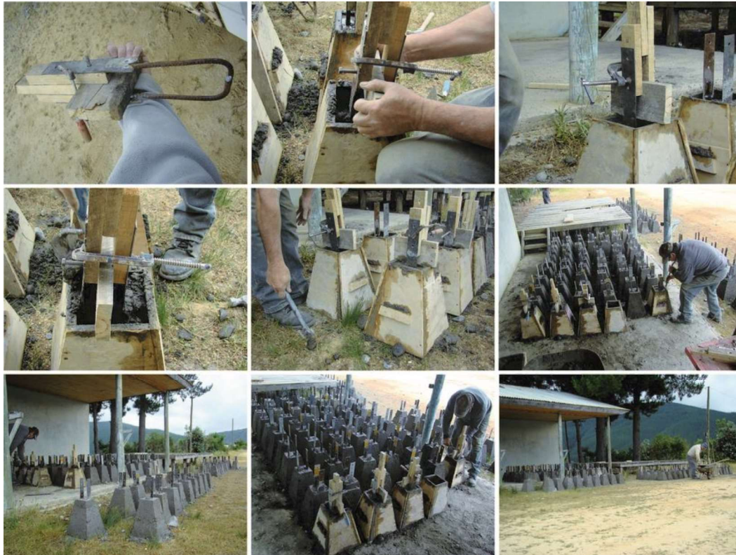
Figura 87: Processo de pré-fabricação das sapatas de concreto das fundações que sustentam a obra
