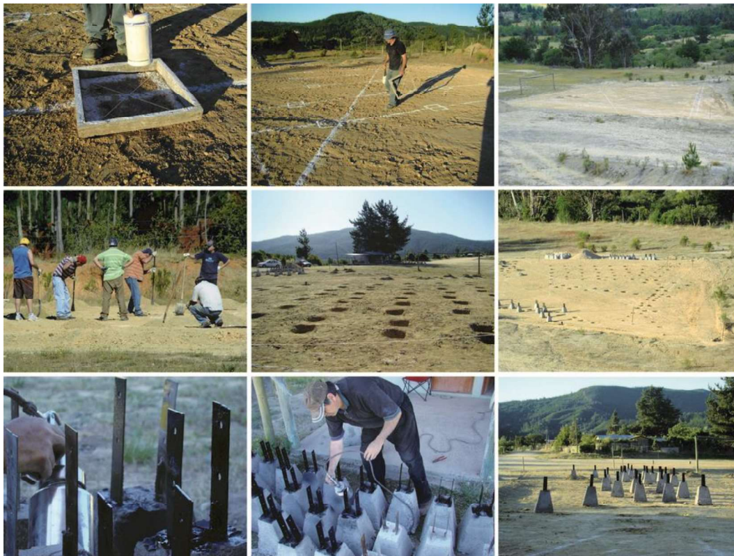
Figura 88: Processo de marcação, escavação e inserção das sapatas no terreno Fonte: Caderno de memórias de título do Santuário Seis Virgens
