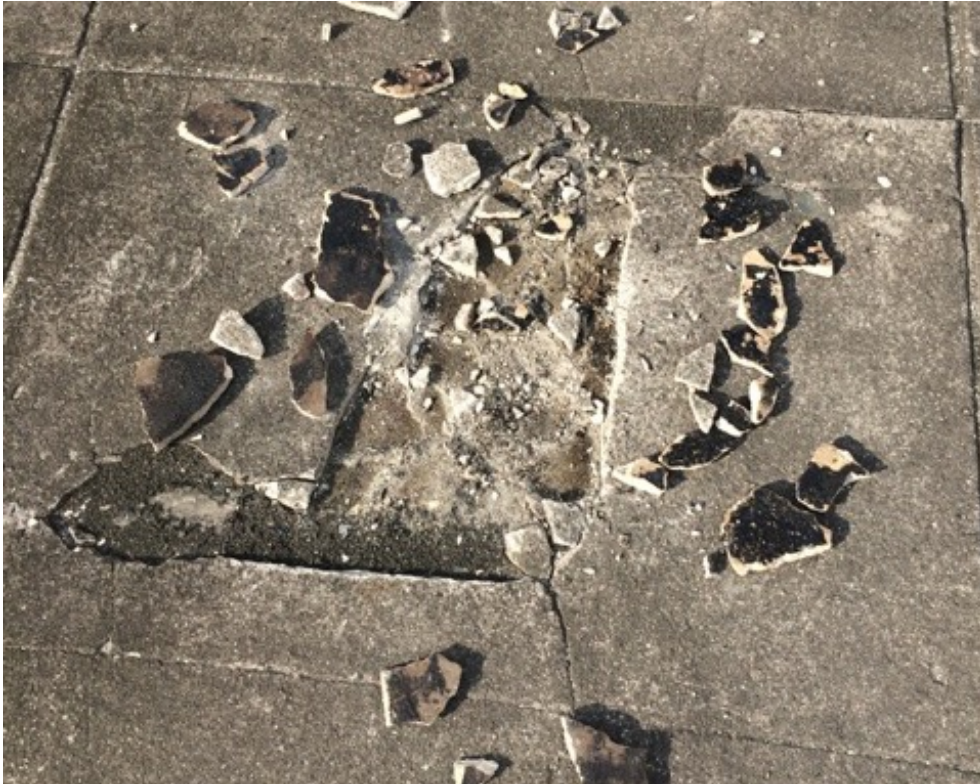
Figura 4.4 – Desprendimento do contra piso, expondo a manta
