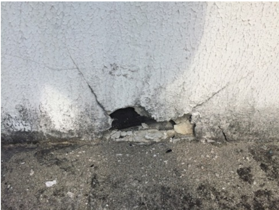
Figura 4.5 – Desprendimento do rodapé, expondo sistema de impermeabilização.
