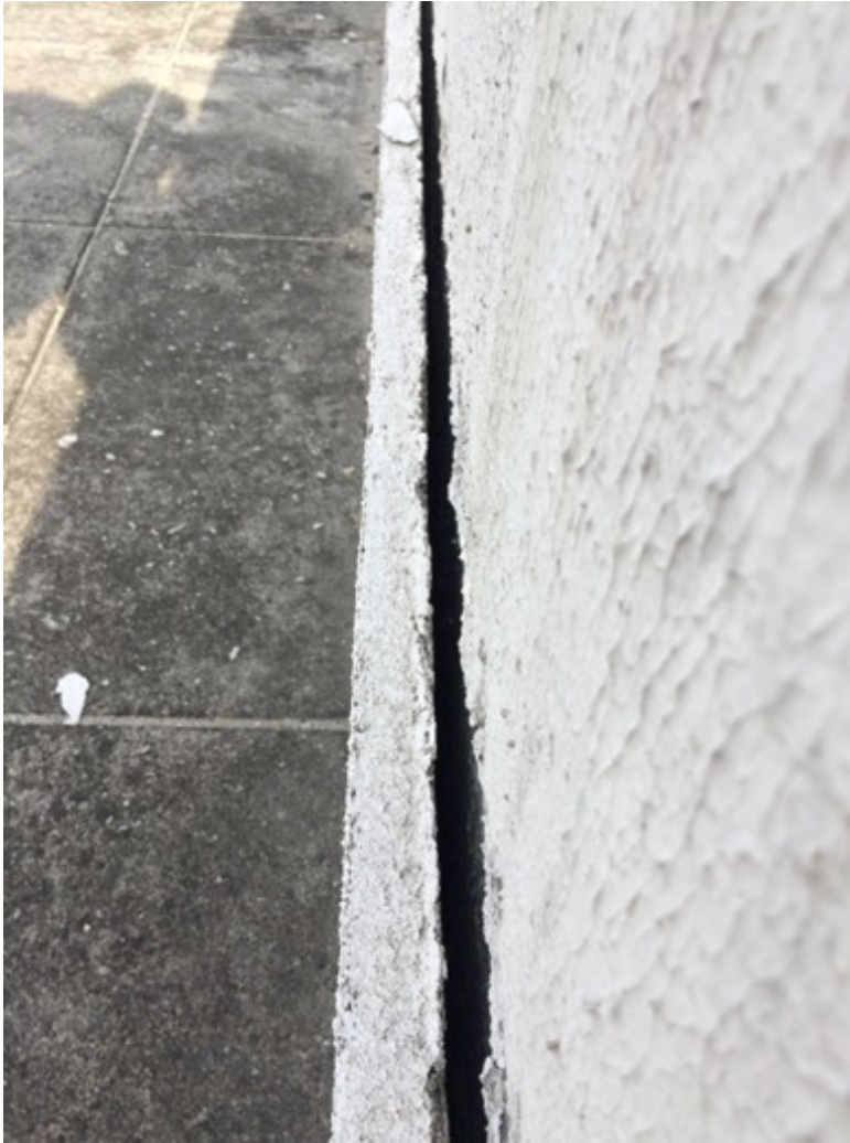
Figura 4.6 – Desprendimento do rodapé, abrindo espaço para penetração de água.
