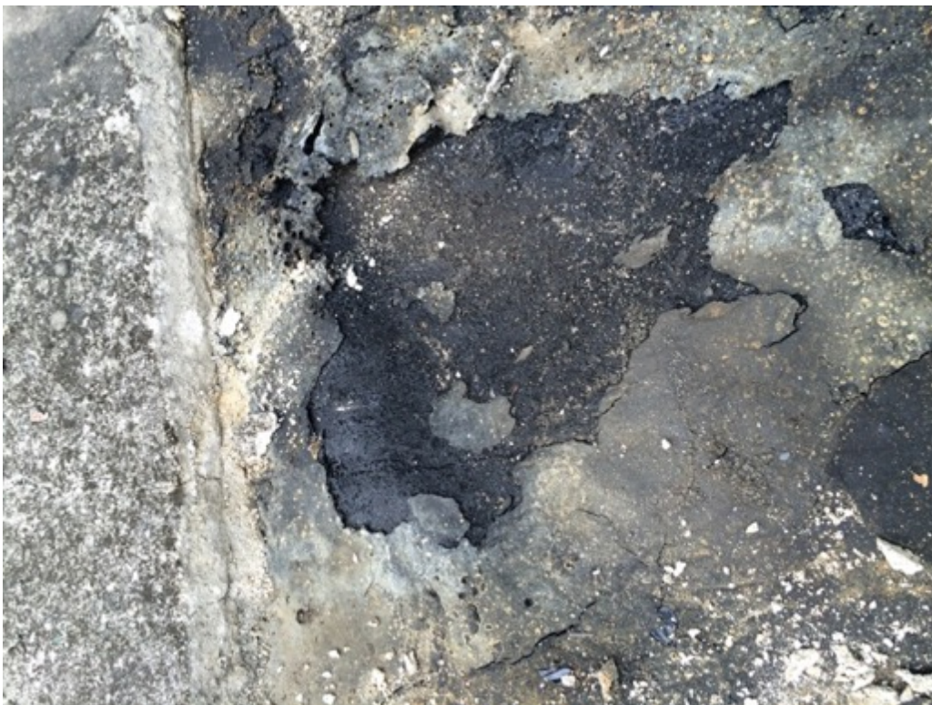
Figura 4.3 – Desprendimento do contra piso, expondo a manta.
