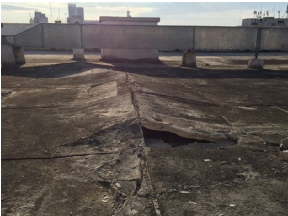
Figura 4.7 – Desprendimento e levantamento do contra piso, expondo sistema de impermeabilização.
