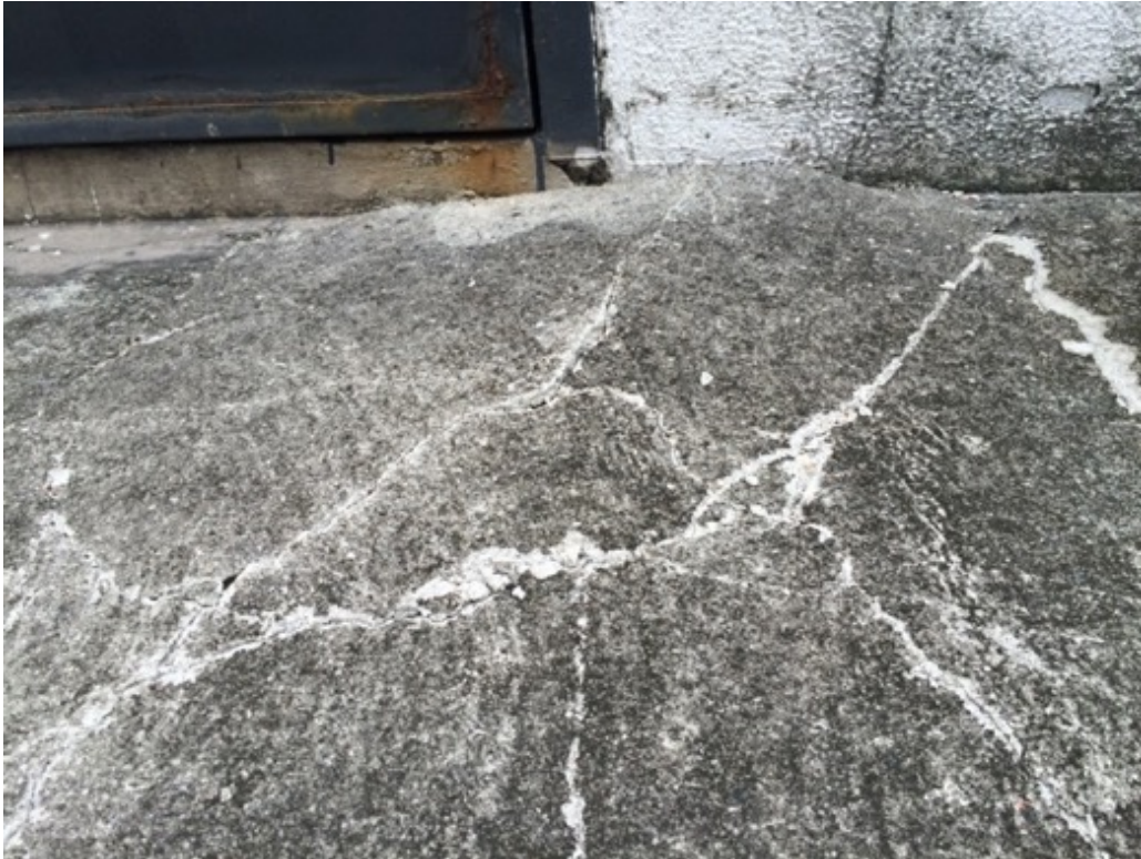
Figura 4.2 – Contra piso de um dos blocos com trincas e desprendimento.
