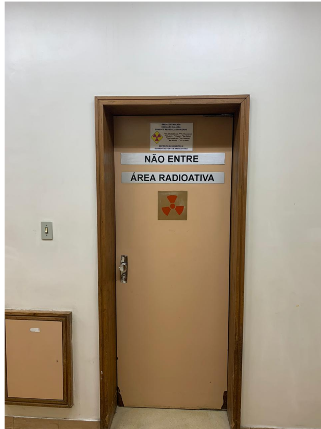
Figura18: Sinalização - porta de acesso à área controlada.
