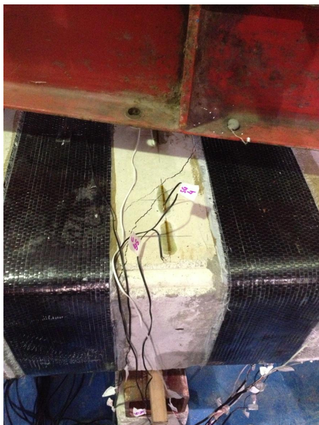
Figura A.4.4 – Fissuras viga VRC-2 na região de observação.
