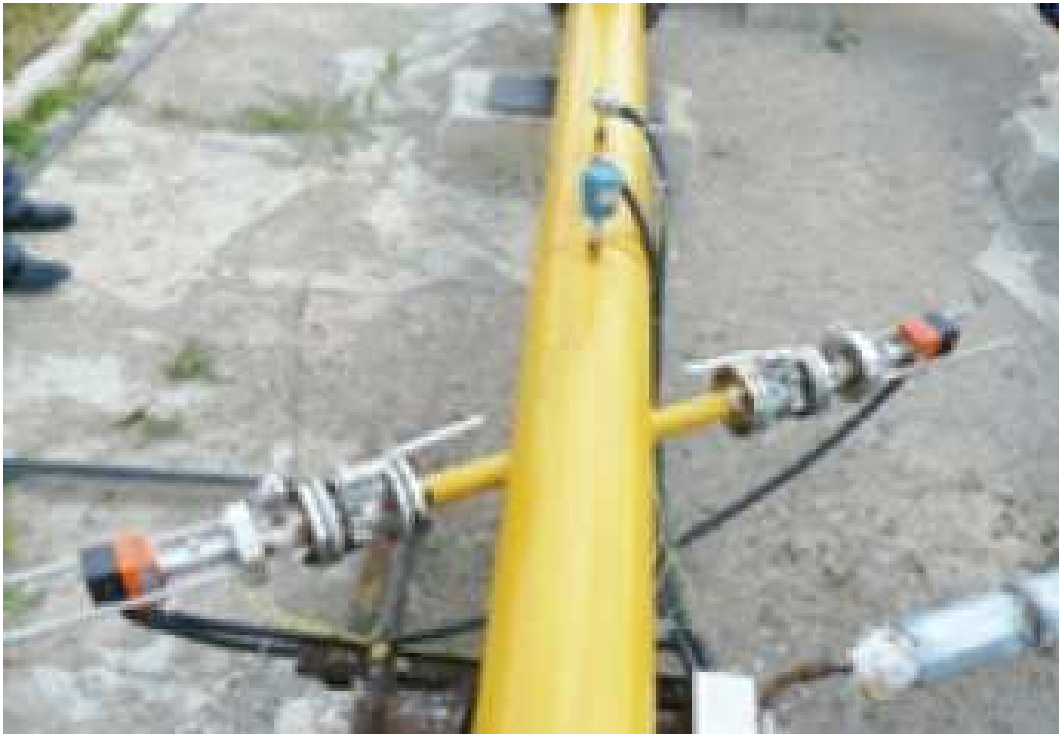
Figura 6 - Medidor típico, transdutores em plano longitudinal diametral (NPP, 2007)
