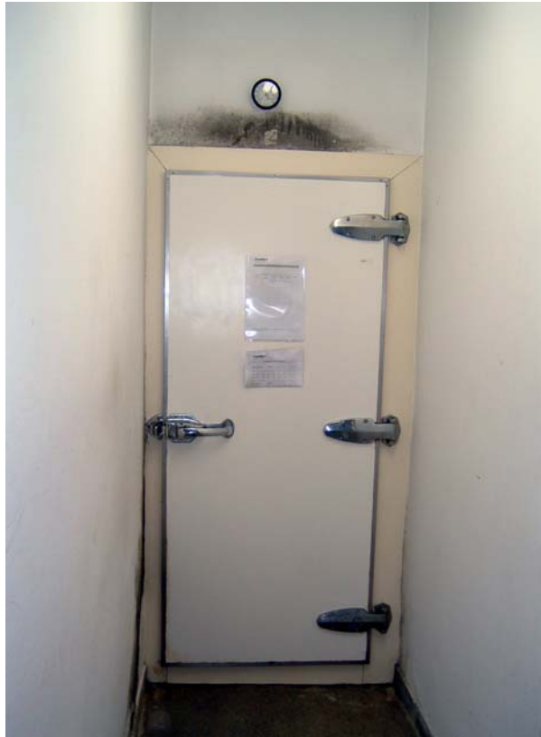
Figura 6. Câmara frigorífica para armazenagem de amostra (provas) -5^{\circ}\text{C} < T < +5^{\circ}\text{C} .
