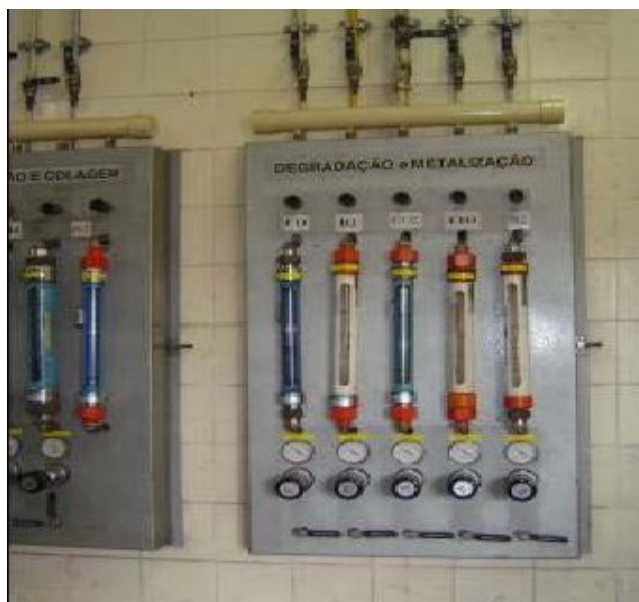
Figura 64 - Paineis com rotômetros controladores da vazão dos gases utilizados nas experiências de carburização.
