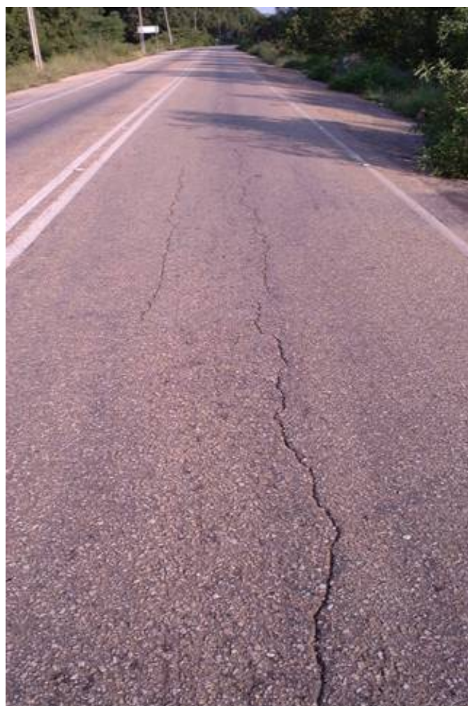
Figura 1.3 – Longa trinca longitudinal causada pelo tráfego.
