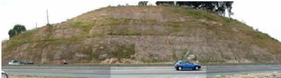
Foto 2 – Talude do Solo de Duque de Caxias (Nunes, 2002).
