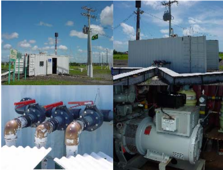
Figura 2.10 – Parque Sócio Ambiental de Canabrava – Dutos de Entrada do Gás, Válvulas de Entrada e Gerador.
