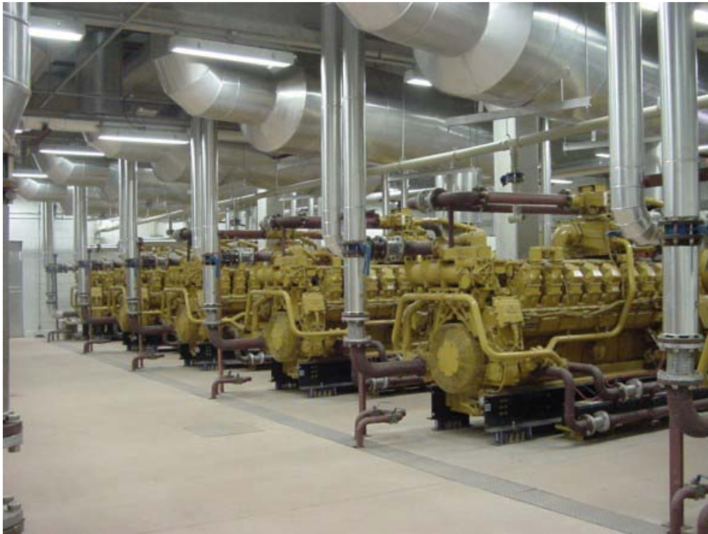
Figura 2.8 Aterro Bandeirantes – Moto-geradores Fonte: Site ARCADIS Logos Energia
