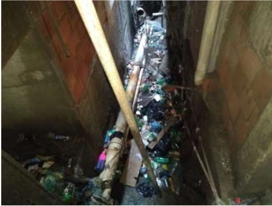
Figura 62 – Resíduo sólido descartado inadequadamente em corpos d'água. Fonte: Maria Izabel de Carvalho, maio. 2021.
