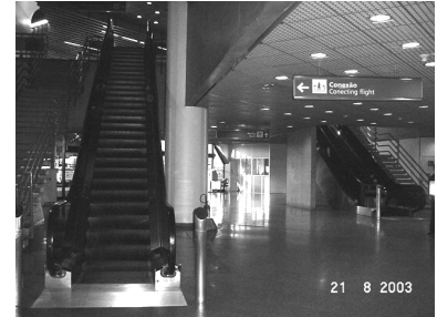
Figura 86 – Escada rolante que sobe e escada rolante que desce (ao fundo).
