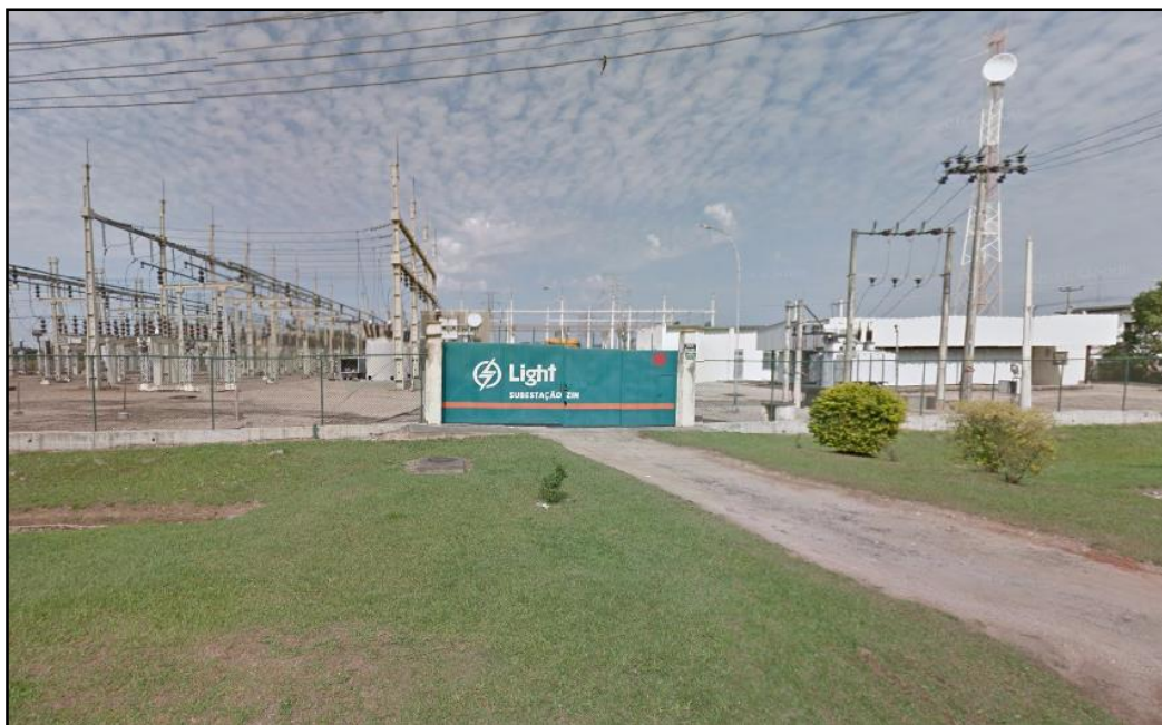
Figura 22 - Vista Frontal da entrada principal da Subestação Light Zin.
