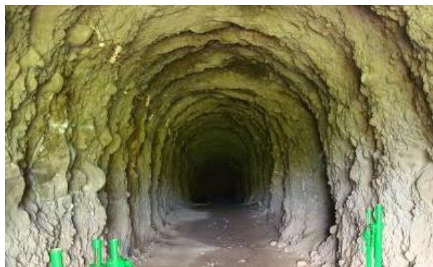
Figura 4.6 – Exemplo de galeria de investigação escavada no conglomerado meio-grosso no local da barragem do PHED (Cerdas et al. , 2009).
