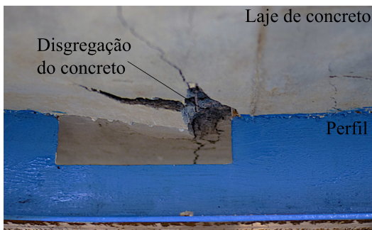
5.27(a): Desagregação do concreto
