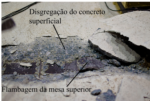
5.25(a): Desagregação do concreto
