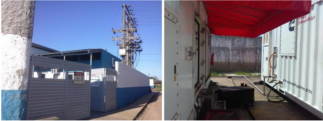
Figura 19 - Marcas do alagamento no muro da UTE Careiro da Várzea Fonte: Arquivo pessoal
