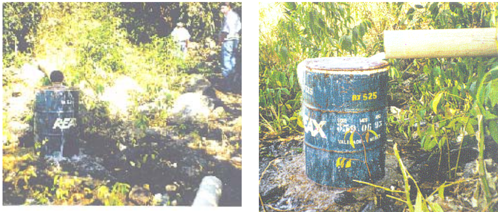
Figura 3.7 Surgência d'água com vazão de 260 l/min. (Furnas relatório de visita à obra N° 091, 1997).
