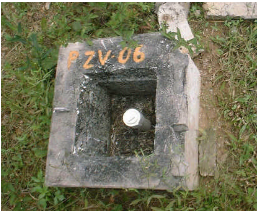
Figura 43 - Piezômetro instalado no vertedor (PZV-06)
