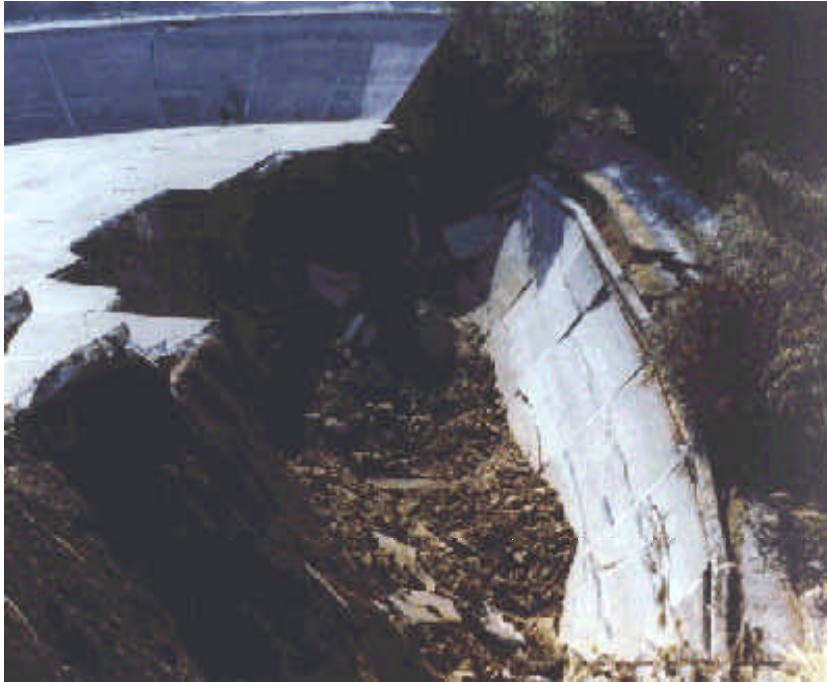
Figura 11 - Ruptura da barragem de Centralia (USBR, 2003)
