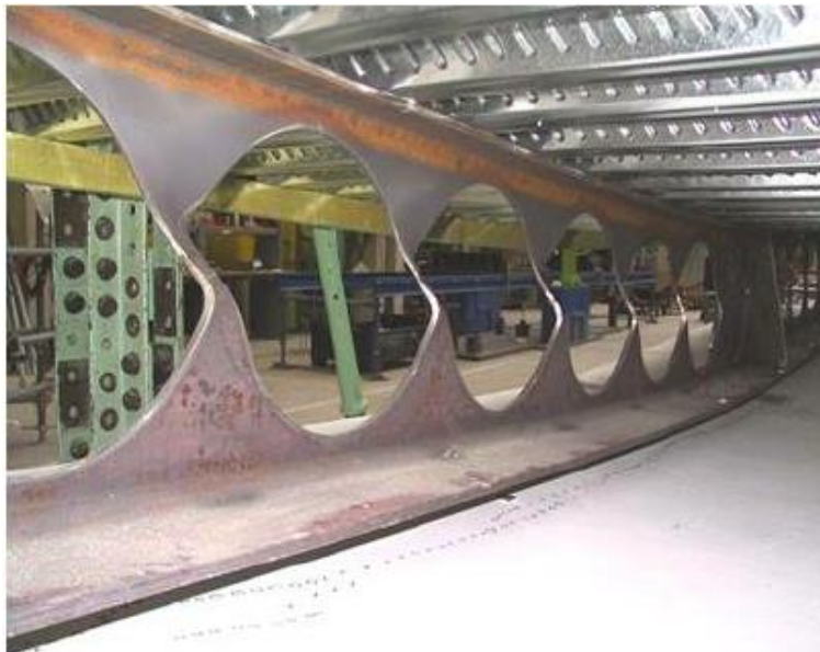
Figura 4.5 – Viga deformada após flambagem no montante da alma por cisalhamento [33]
