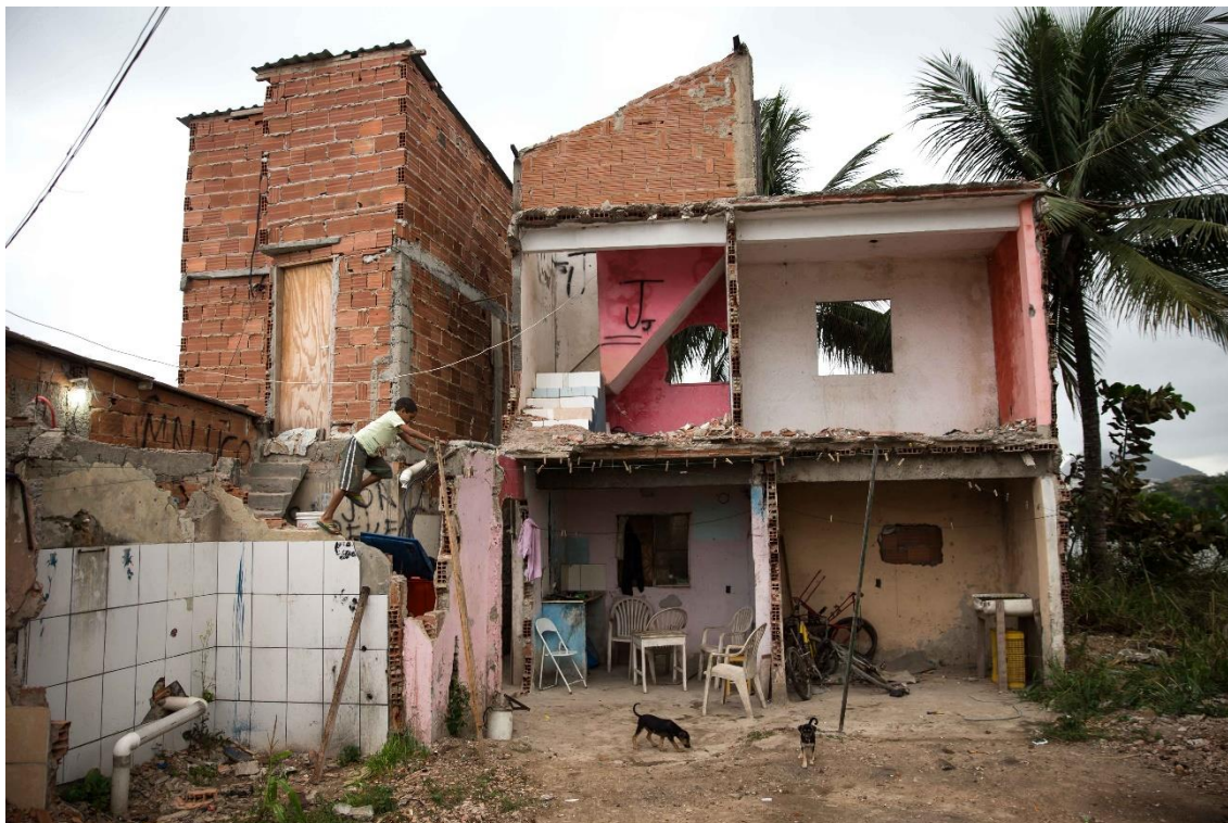
Casa parcialmente demolida na Vila Autódromo (ano não informado). Foto: Ricardo Borges.
