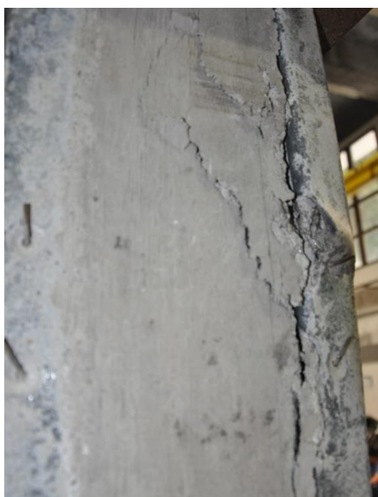
Figura 4.14 - Detalhe da ruptura do concreto do Pilar 02.
