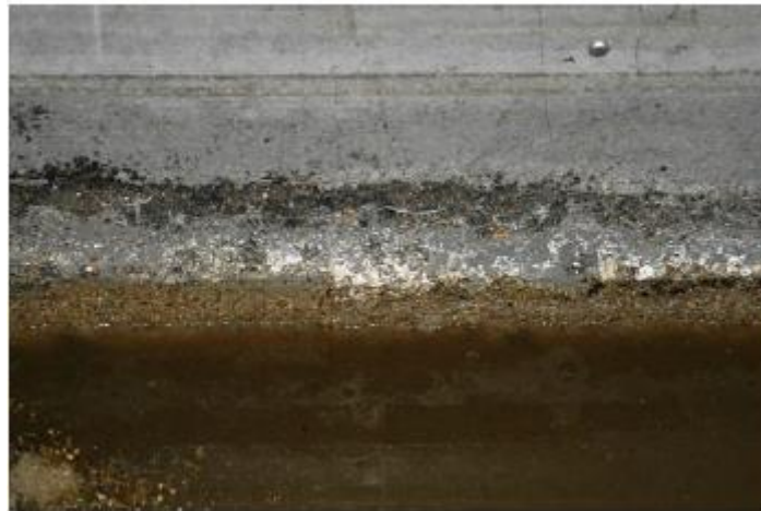
Figura 1.1 – Sinais de corrosão em estrutura de concreto em uma rede de tratamento após 7 anos de serviço [11].
