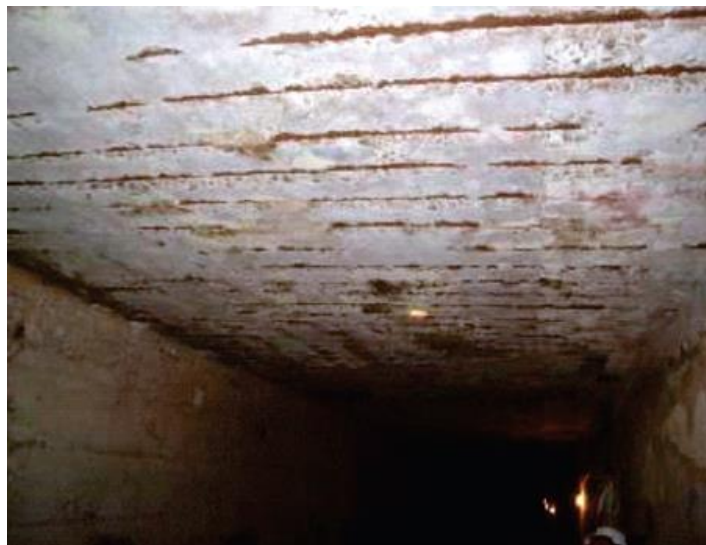
Figura 2.3 – Teto de galeria de águas pluviais com sinais de degradação devido à ação de H_2S [2].
