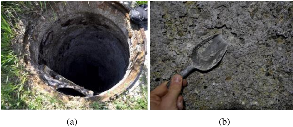
Figura 2.4 – Parte superior da tubulação por gravidade presente em uma rede de esgoto na Áustria apresentando sinais de degradação [16].
