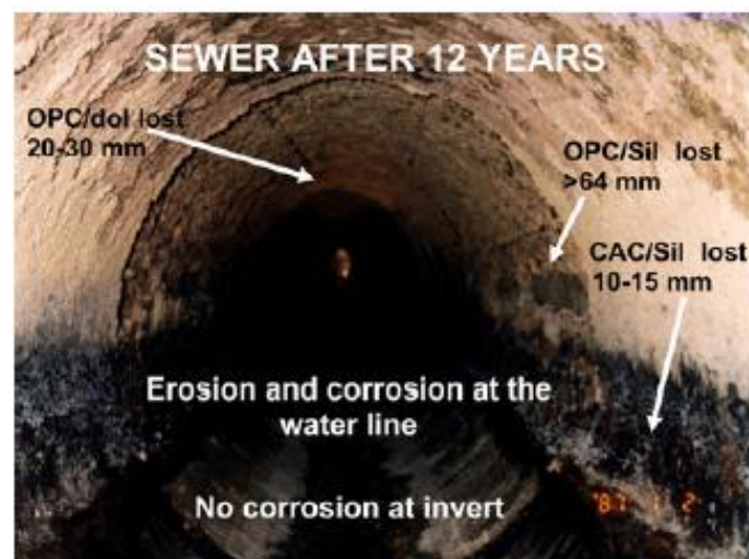
Figura 2.14 – Tubulação para ensaios in loco com regiões constituídas por diferentes materiais e perda de espessura dos mesmos devido à corrosão [35].
