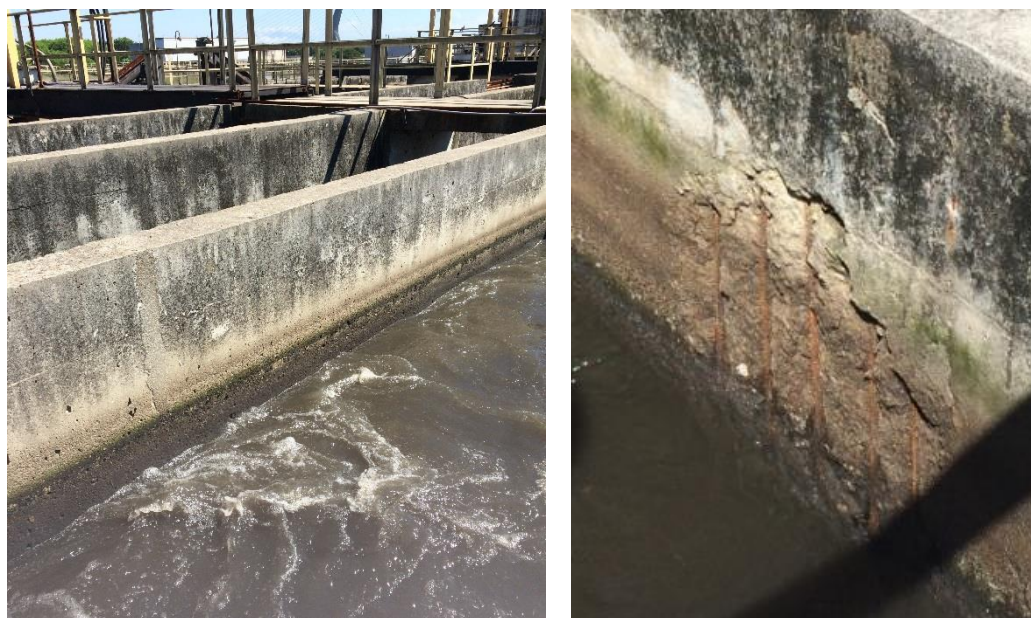
Figura 3.5 – Sinais de corrosão na rede de transporte de esgoto antes de qualquer tratamento.
