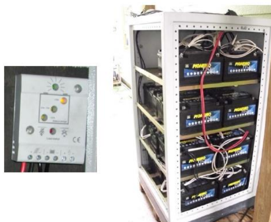
Figura 2.15 – Controlador de carga e banco de baterias do EV da UTFPR
