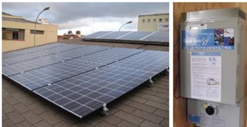
Figura 2.14 – Painel fotovoltaico do Escritório Verde da UTFPR
