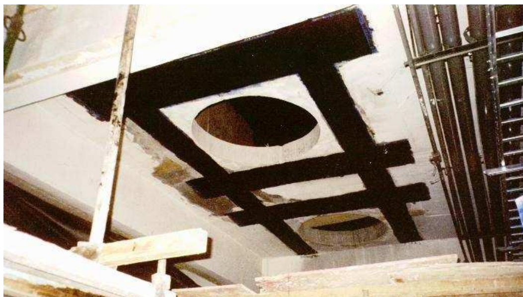
Figura 2.14 – Fábrica de Laticínios Itambé em Sete lagoas MG, onde foi executado um reforço ao redor dos furos na laje ( http://www.cesec.ufpr.Br/pet/titulo/biblioteca/seminarios/arquivo_seminarios/construcao_civil/reforco_estrutural_com_fibras_de_carbono.pdf , visitado em 20/09/08).
