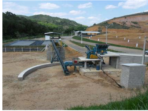
Vista geral do Sistema do Britagem Fonte: Consórcio N/I. Relatório nov/2012.
